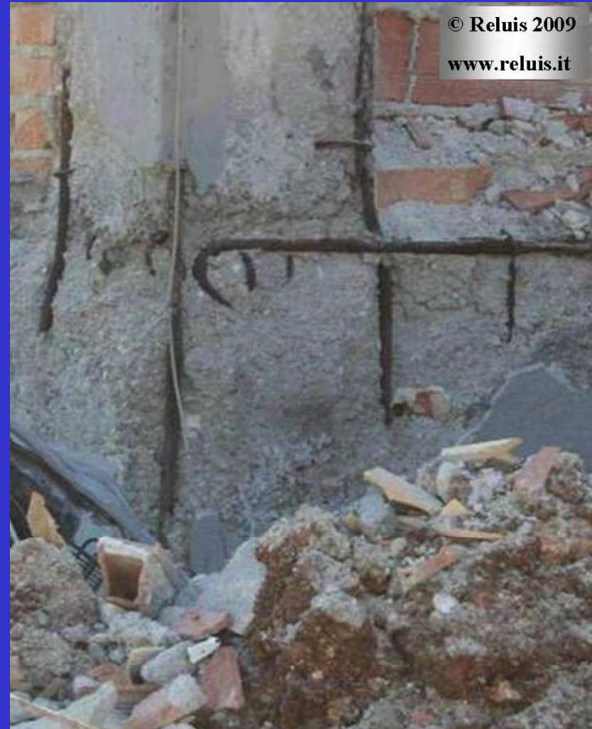
Scarsa qualità del calcestruzzo
