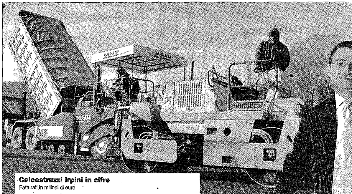
Sotto, Silvio Sarno A lato, un impianto di betonaggio
