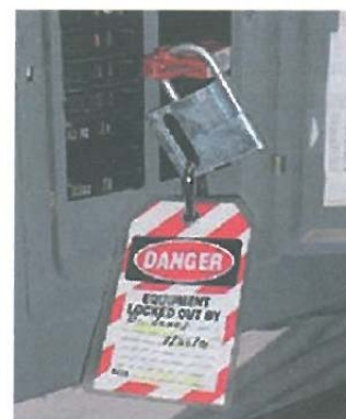
Sezionatore elettrico bloccato e segnalato
