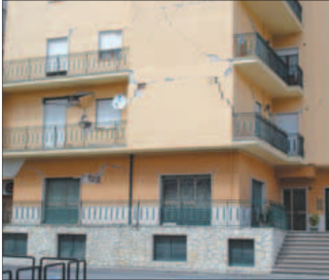
Danni agli elementi non strutturali di un fabbricato in calcestruzzo armato degli anni '70.
