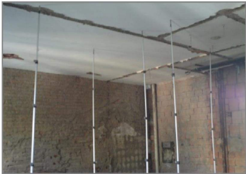
Posizionamento dei sensori elettronici
